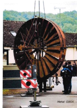
Le démontage de la roue a été une opération spectaculaire. © Droits réservés
